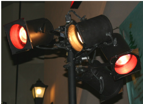
Lighting pole with 3 Altman Par 38's
